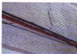
外牆立面龜裂
