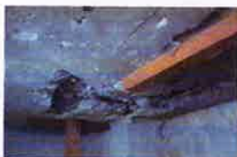
天花板鋼筋外露
