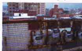
屋頂瓦斯表及管線
